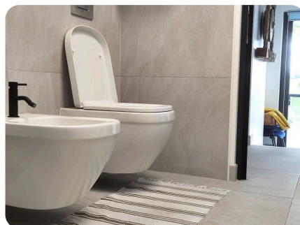
Casa de banho com equipamento Grohe
