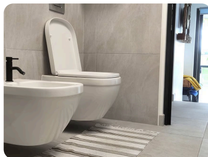
Salle d'eau équipée Grohe
